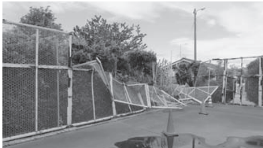
倒壊したテニスコートフェンス
