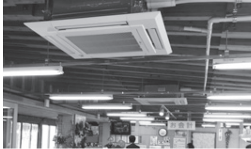
2カ所にエアコンを設置した産直市場
