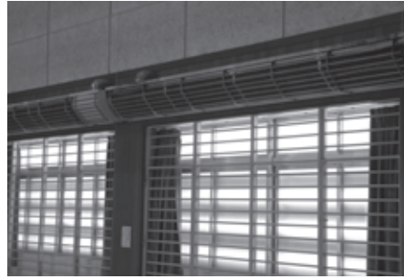
B & G 体育館暖房設備
