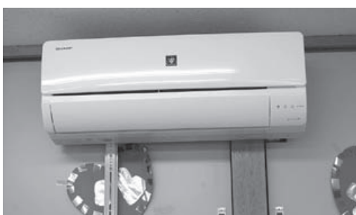
各保育所に設置されたエアコン
