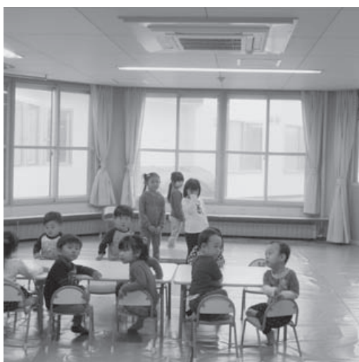
保育所エアコン設置工事（すくすく保育所）、村内全保育所にエアコンを設置
